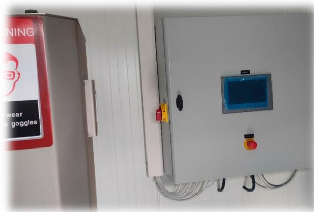
Widok prasy do odwadniania osadów ściekowych w kontenerze (3 zdjęcia)
