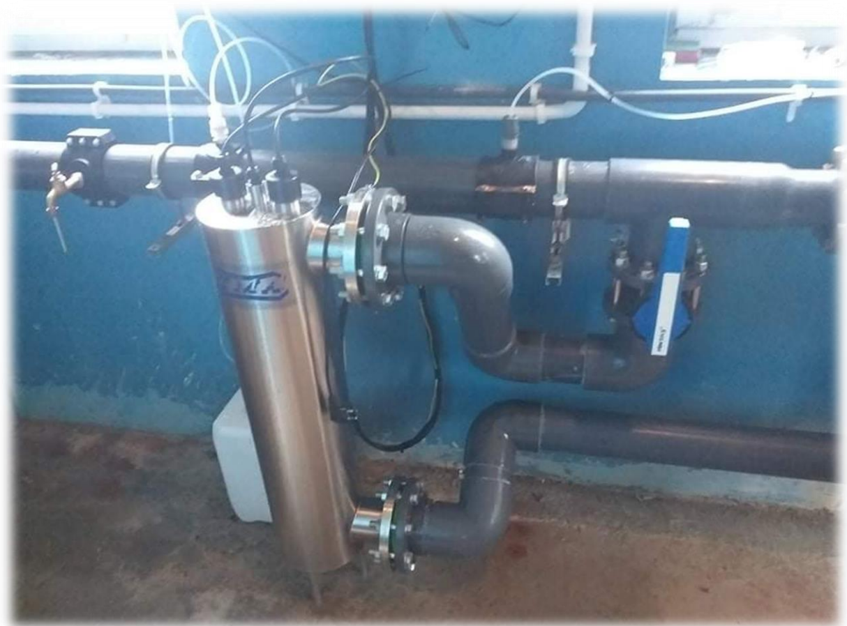
Zdjęcie części zamontowanych urządzeń
